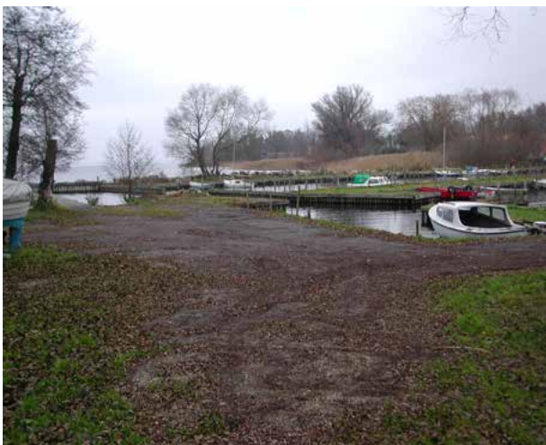
På Fiskerens Hjørne ses nedbrudt asfalt. Foto december 2003.
