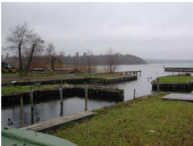
Havnen havde, som det ses, snævre småbassiner og passager. Det fornemmes, at stolper og tvinger ikke har det godt. Foto december 2003.
