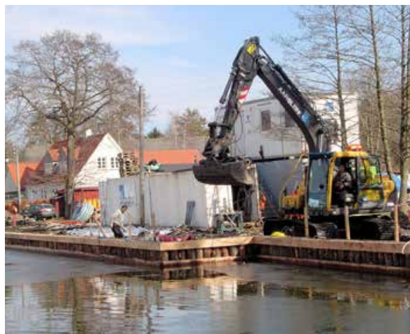
Landfortøjningspæle fastgøres til molekanten og sættes i midten af hver bådplads. Foto 27/3 2008.
